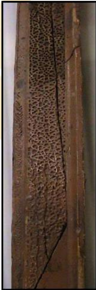
تصویر ۲۷: ترکهای بزرگ روی نوار تزئینی چهارچوب حاکی از آسیب زیاد به دلیل شرایط نامناسب موقعیت نصب می باشد.
