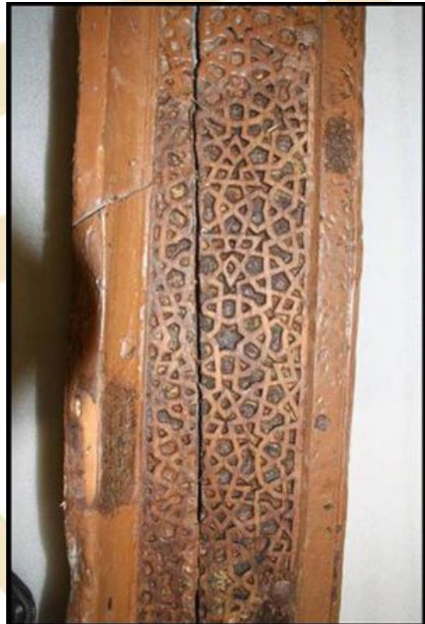
تصویر ۲۶: ترکهای بزرگ روی نوار تزئینی چهارچوب حاکی از آسیب زیاد به دلیل شرایط نامناسب موقعیت نصب می باشد.
